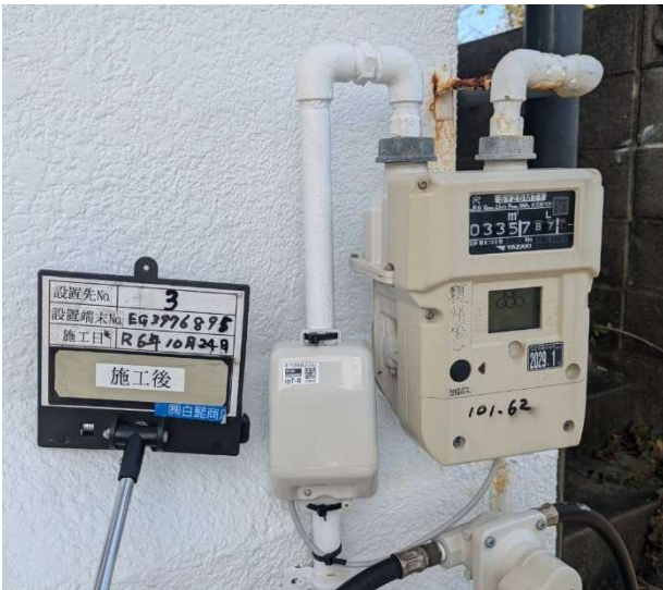
設置後のメーターとLPWA通信端末
