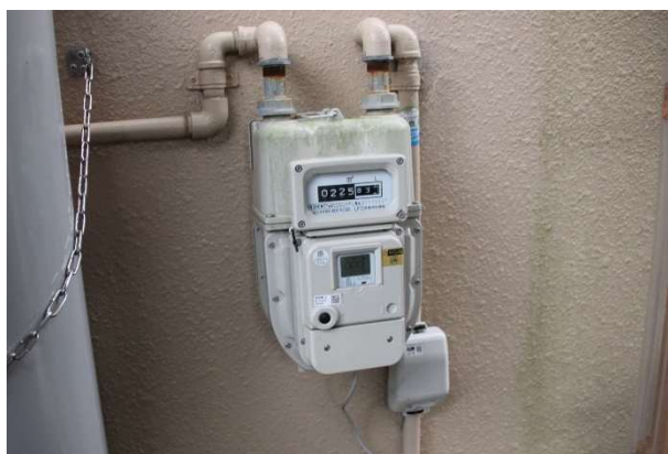
顧客宅に設置されたLPWA端末
