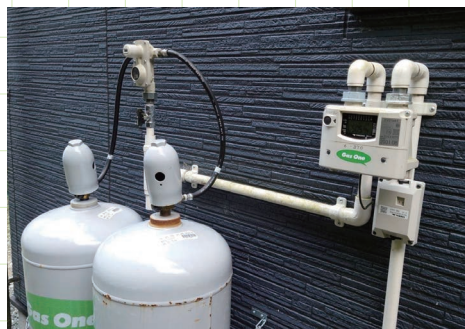
LPWAの現場設置状況
