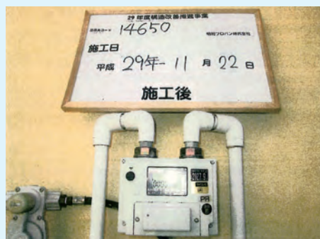
タッチ検針対応型メータへの更新
